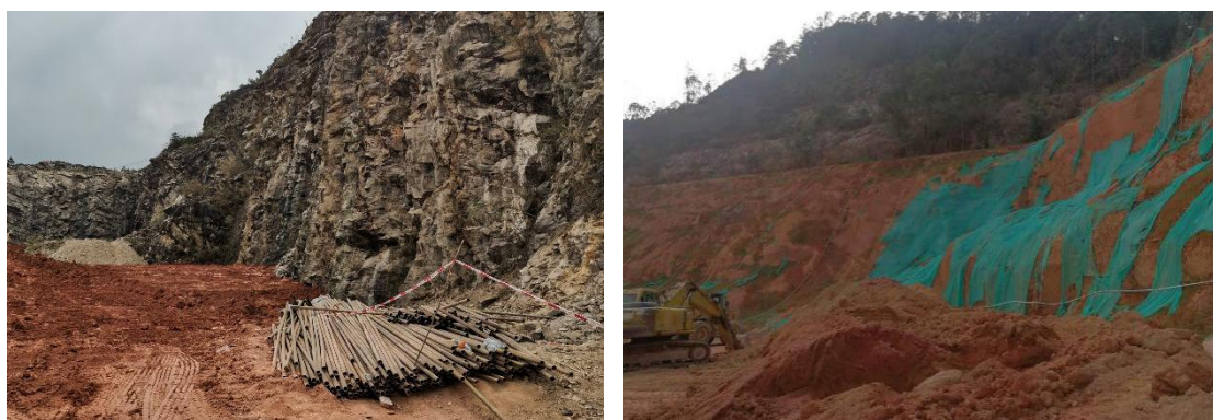
图 2 中南石场危岩未清理即开展施工（左）联发石场团粒喷播材料配比与设计不符（右）
