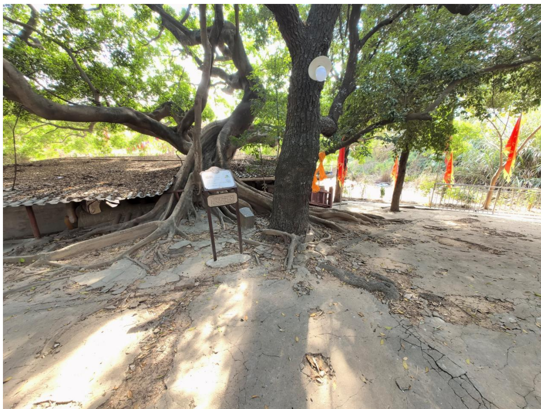
图 2-10 部分铺装已被发达的根系破坏
