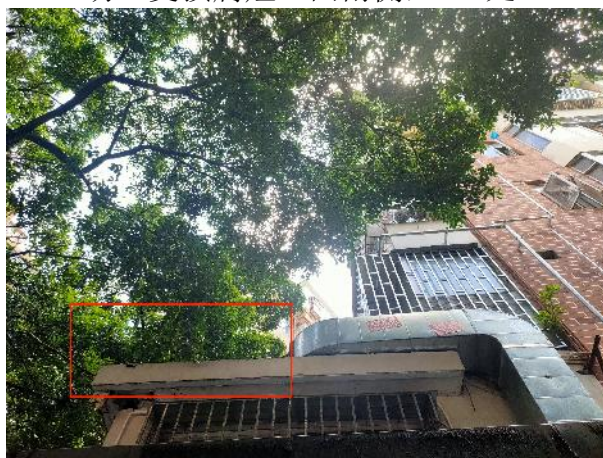
适当修剪延伸至居民楼的枝条（东南侧，8m 处）
