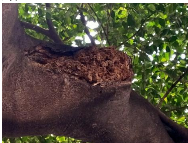
切口受损腐烂（西南侧，2m 处）
