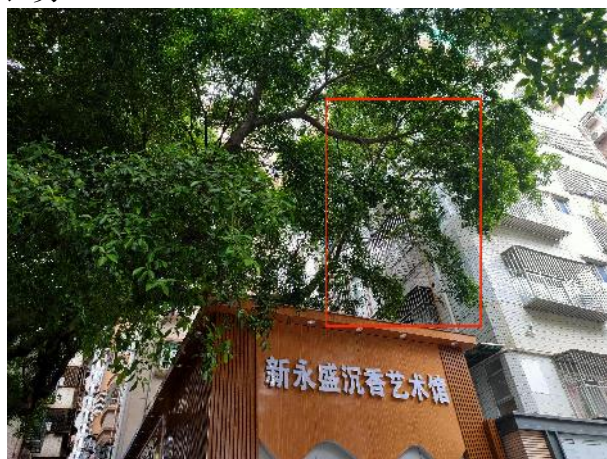
适当修剪靠近建筑的过度延伸枝(西北侧, 8m 处)
