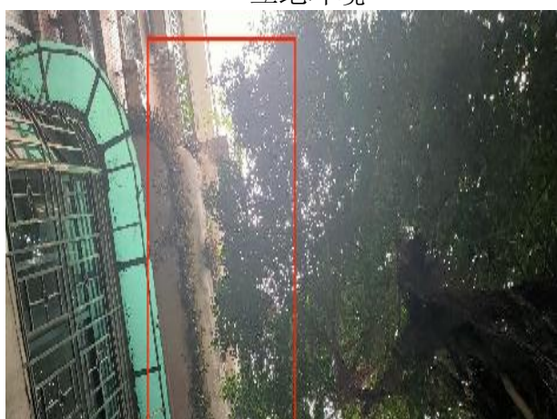
适当修剪靠近建筑的过度延伸枝（西侧，12m 处）
