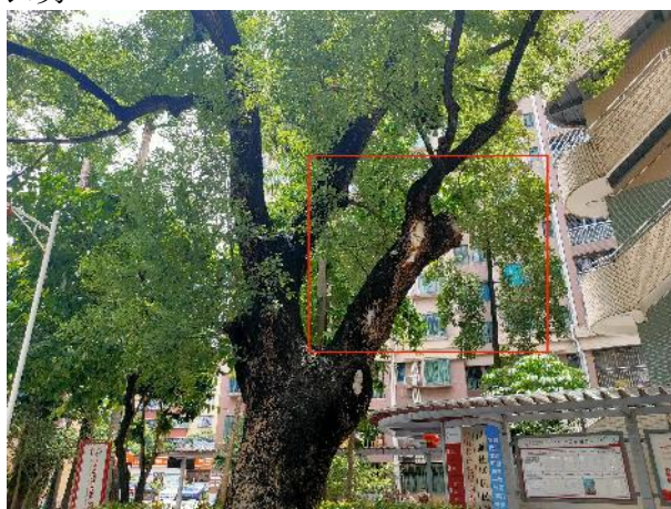
树洞修补面破裂（西南侧，4.5m 处）
