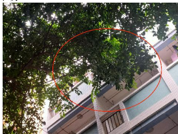
适当修剪靠近建筑的过度延伸枝（东侧，8m 处）
